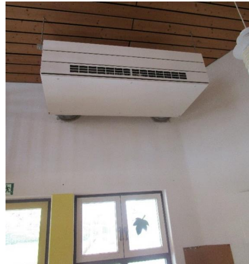
Lüftungsgerät in der Kinderwelt „St. Martin“
