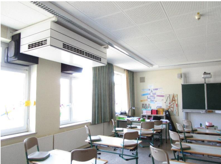
Lüftungsgerät in einem Klassenzimmer der Grundschule
